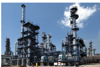
サルファーフリーガソリン製造設備
