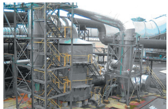
日鉱製錬(株)佐賀製錬所の硫酸工場転化器設備
