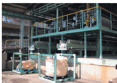
飛灰の湿式処理実証化試験設備(ろ過設備)
