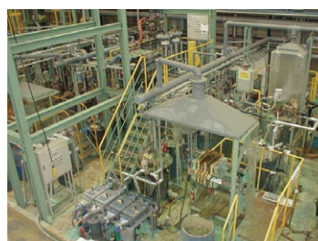
湿式銅製錬パイロット試験設備
